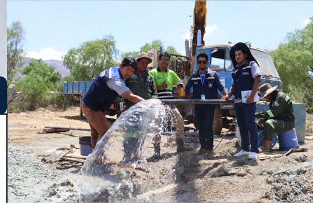
ESMERALDA SUD CAUDAL 3,8 l/s
